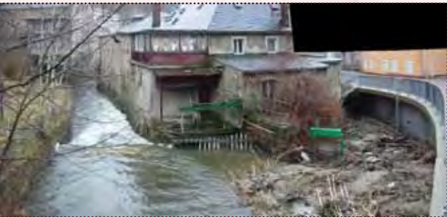
Ehemalige Wasserkraftanlage in Sebnitz nach dem Hochwasserereignis Quelle: Planungsgesellschaft Scholz + Lewis mbH Dresden, Steve Kobsch, Tel. 0351-2168345
