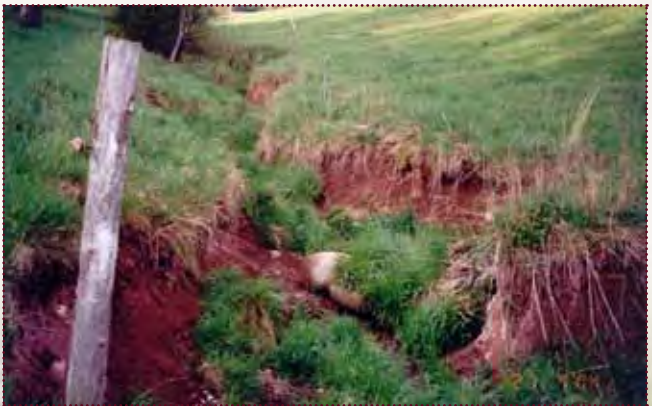
Veränderungen am Bach nach dem Hochwasserereignis Fotos: ÖkoProjekt ElbeRaum Dresden GmbH
