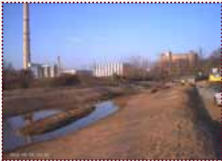
Polder Reick nach der Fertigstellung 2011 Quelle: Landeshauptstadt Dresden, Umweltamt
